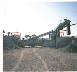
破砕機側面 中央は吊下式磁選機 磁選物は手前に落ちる
